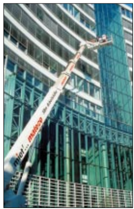
Großeinsatz von sieben mateco-LKW-Arbeitsbühnen zur Gebäudeaußenreinigung an der Frankfurter Welle. Foto: Sabine Pallascio
