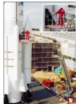
Bei max. 55 m Arbeitshöhe oder 25 m seitlicher Reichweite konnten schwierig zugängliche Stellen problemlos angefahren werden.
