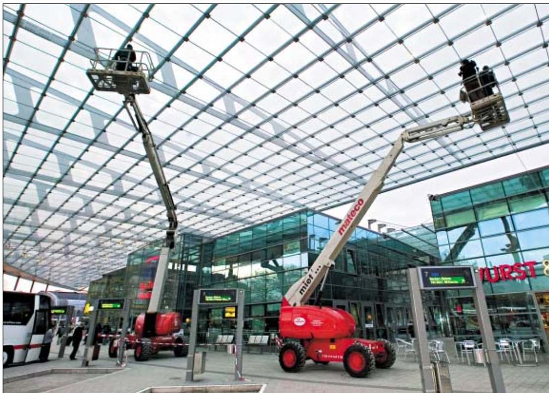
Das freitragende Glasdach des Zentral-Omnibus-Bahnhofs wurde mit der Kombination TG 264 K D 4x4 und T 221 K D 4x4 gereinigt.
