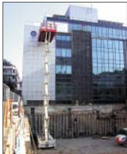
Ausgefahren bis auf 22,5 m Arbeitshöhe steht die Scheren-Arbeitsbühne S 225 D 4x4 S sicher vor der Gebädefassade.
